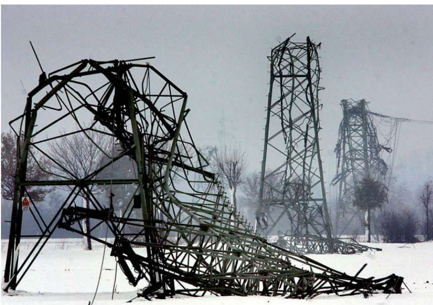
Mastbruch im Münsterland 2005.
